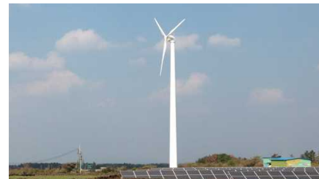
产品型号:FD21-100 项目地点:韩国济州岛 运行时间:2013年 项目说明:韩国岛屿微电网试点项目
